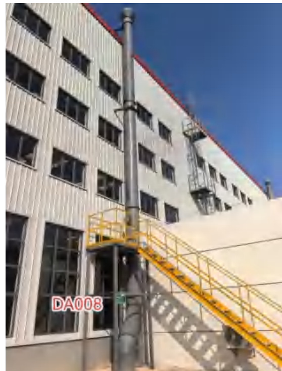
DA008 抛丸废气排气筒 1 废气处理设施为旋风除尘器、圆布袋除尘器
