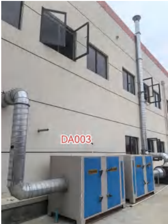
DA003 发泡熟化废气排气筒废气处理设施为二级活性炭吸附装置
