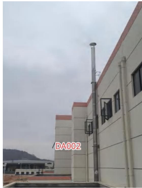
DA002 蒸汽发生器燃烧废气排气筒
