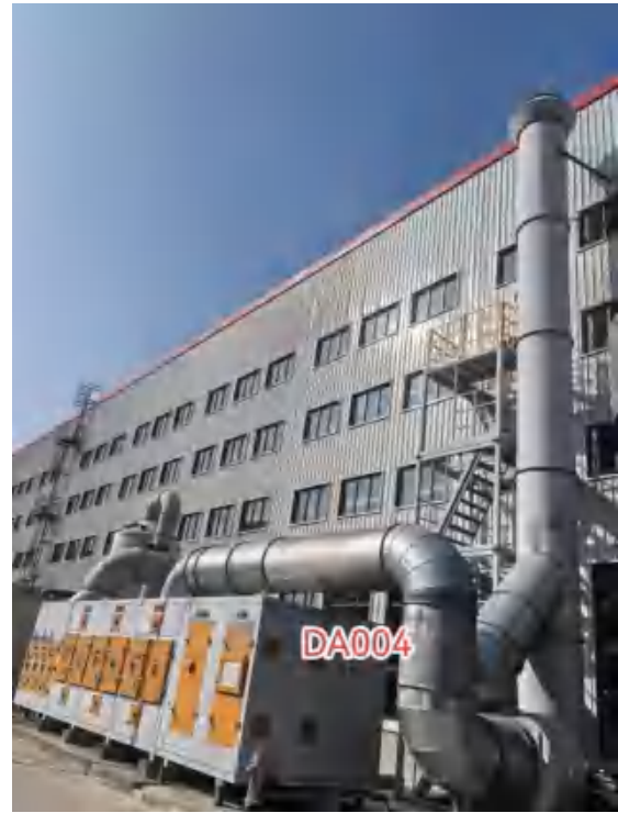
DA004 浇注废气排气筒废气处理设施为水喷淋、过滤棉、活性炭吸附浓缩、CO 催化燃烧装置
