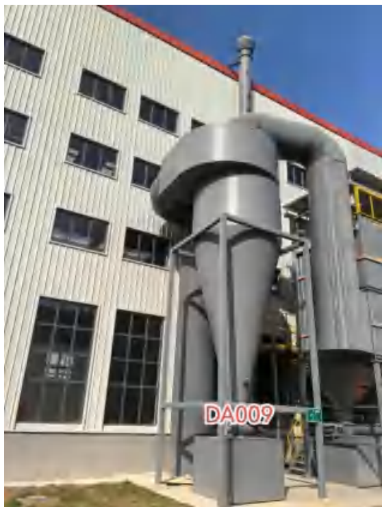
DA009 抛丸废气排气筒 2 废气处理设施为旋风除尘器、圆布袋除尘器
