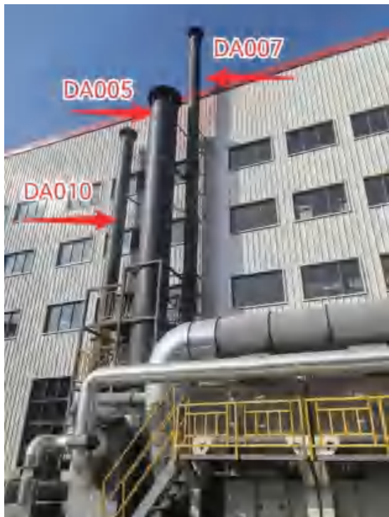
DA007 烘干房废气排气筒废气处理设施为低氮燃烧装置，DA010 吹灰废气排气筒废气处理设施为滤筒式除尘设备
