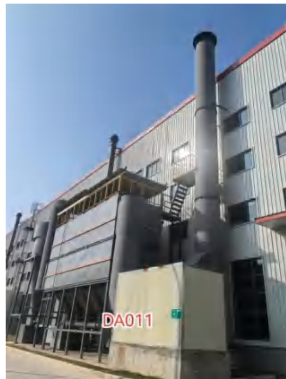
DA011 打磨废气排气筒废气处理设施为旋风除尘器、布袋除尘器
