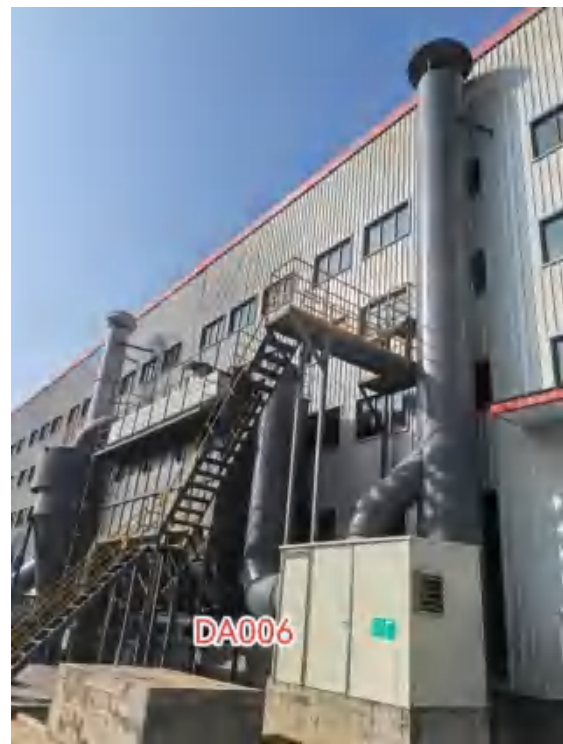
DA006 造型、砂处理废气排气筒废气处理设施为旋风除尘器、布袋除尘器
