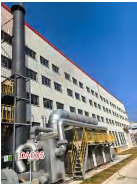
DA005 喷漆废气排气筒废气处理设施为漆雾捕集箱（油漆吸附袋）、干式过滤器、活性炭、催化燃烧装置
